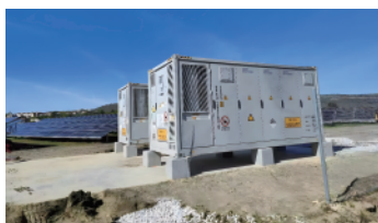
Trazhitsa, Bulgaria 7.45 MWh
