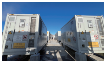
Trazhitsa Bulgaria 20MWh
